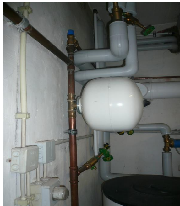
Abbildung 20 Das Ausdehnungsgefäß ist in die Leitung integriert und wird durch das installierte T-Stück durchströmt, wodurch kein Stagnationswasser entsteht
