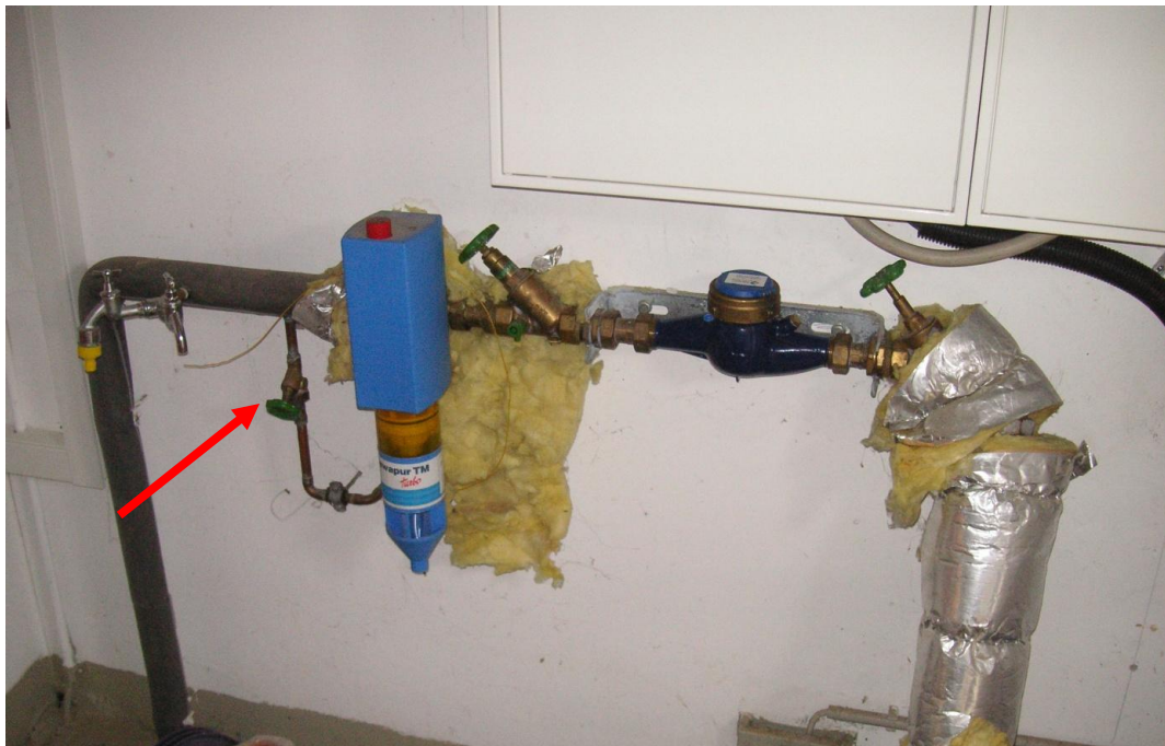
Abbildung 21 In diesem Kindergarten war die markierte Außenzapfstelle, welche nie genutzt wurde, der Grund für Pseudomonas aeruginosa
