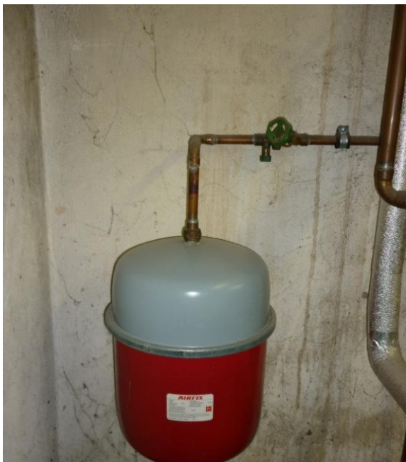
Abbildung 19 Dieses Ausdehnungsgefäß ist weder durchströmt (am Ende einer Leitung, Wasser kann nur hineinlaufen), noch hat es im Trinkwasser etwas zu suchen (Heizungsgefäß!) Durch die Stagnation und das nicht für Trinkwasser geeignete Material kommt es zu Verkeimungen
