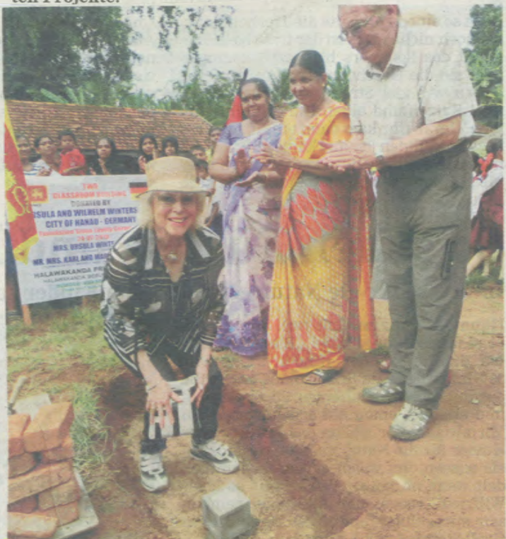
Ursula Winterstein begründete einen Klassentraktneubau der Halawakanda Primary School in einem Armenviertel.
